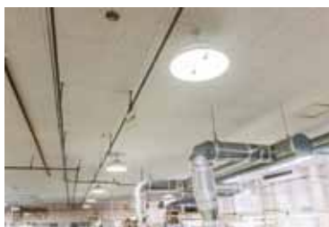
製品化した無電極ランプは工場に設置
